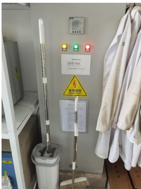
理工楼 1404: 配电柜门前堆放物品
