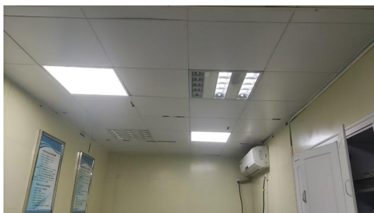
格致楼 1037-2: 灯管不亮, 建议维修
