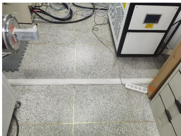
理工楼 118：插线板置于地板上
